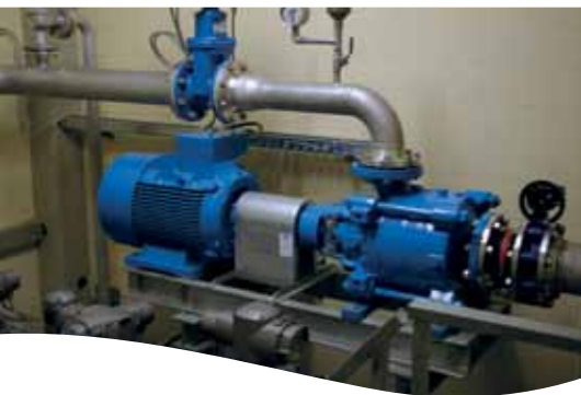
Wasserturbine im Hochbehälter Volkhausen
