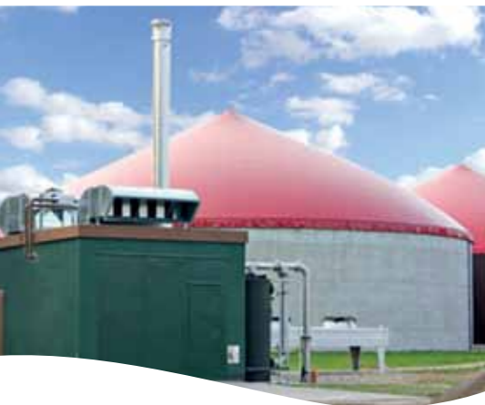
Aufbereitungsanlage für Biogas
